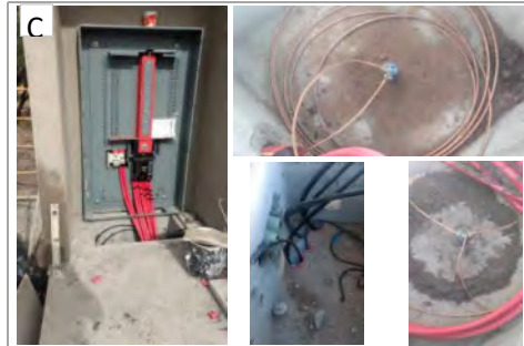
Conexión entre transformador y tableros.
